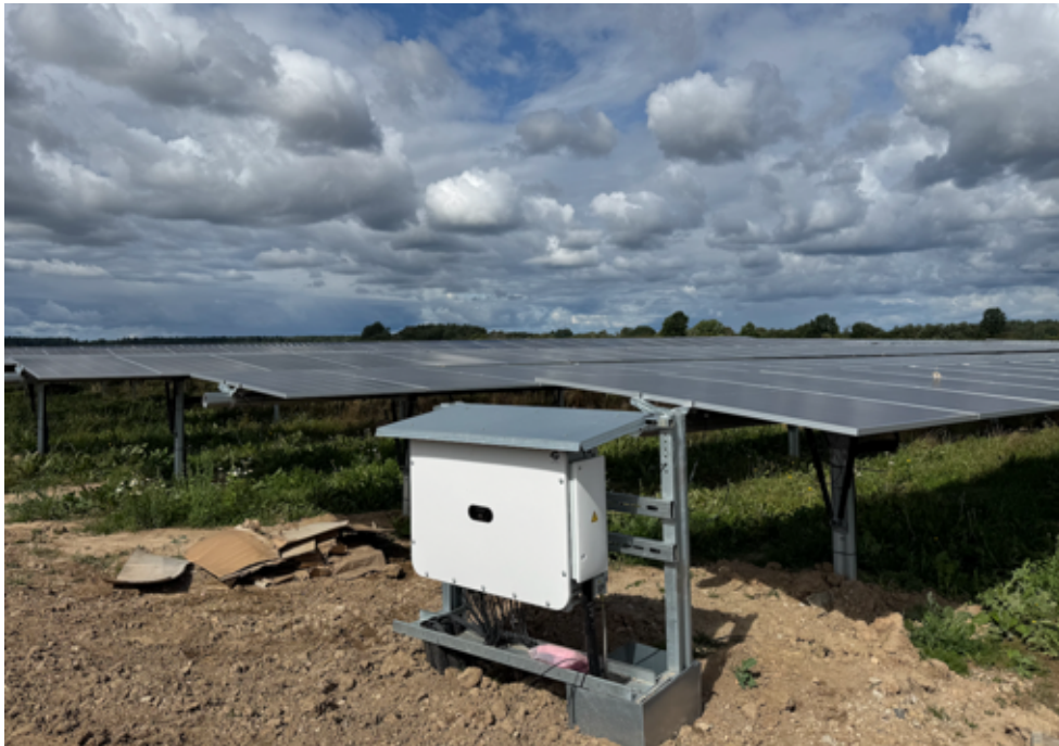
Figur 5-4 Stringinverter i solkraftverk med følgestructur. Bilde Energeia AS.
